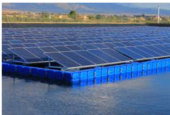
Foto número: Placas fotovoltaicas flotantes en embalse de riego.
